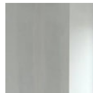
ENDUIT PLÂTRE AMIANTE
